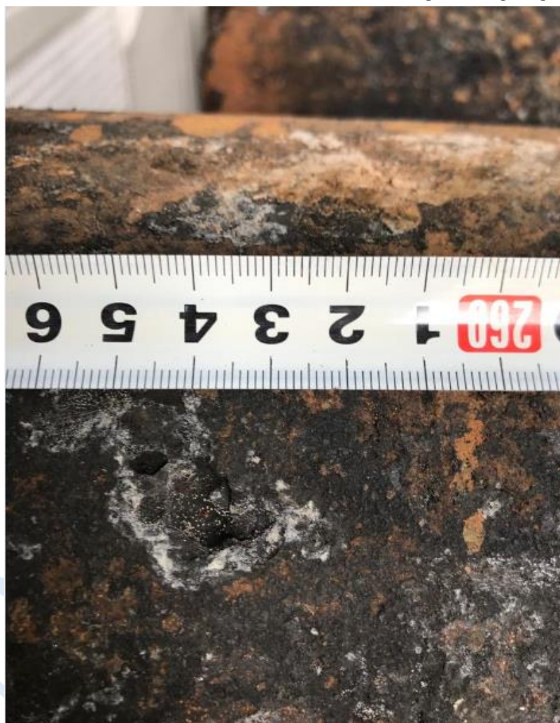
شکل ۹- تجمع نمک بر روی سطح خارجی خصوصا در حفرات
