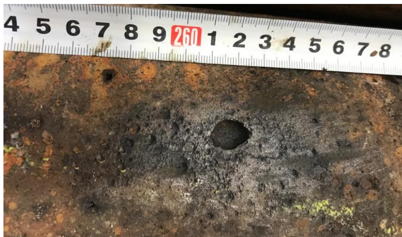
شکل ۸- خوردگی خارجی بر روی لوله‌های دریافتی
